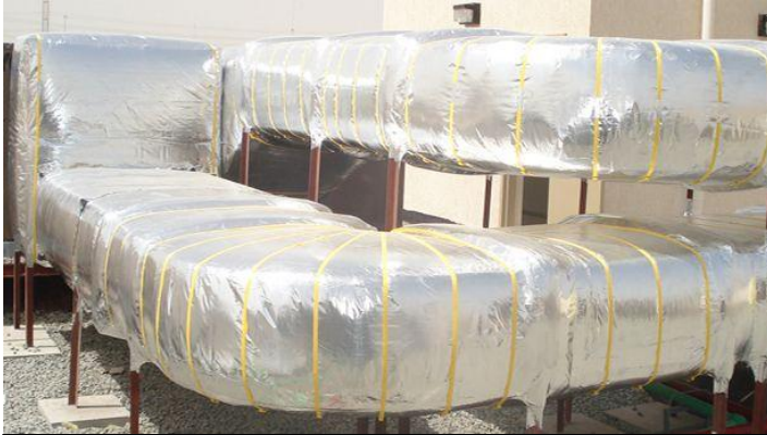
الشكل (8) تغطية وعزل مجارى الهواء
